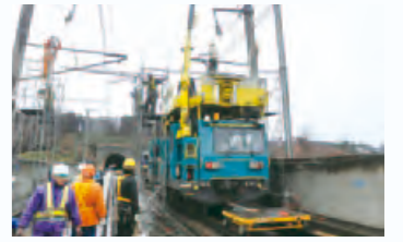
↑東北新幹線の早期運行再開をめざして、軌道クレーンを使って電架柱を取り換える
