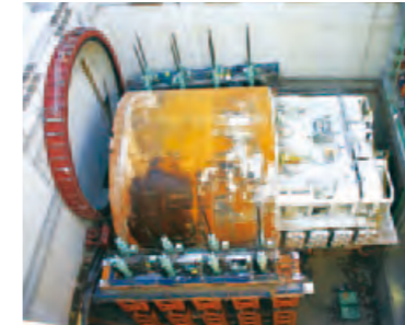
↑地上から見下ろしたシールドマシン。直径は13.6mで、泥土圧としては国内最大径を誇る
