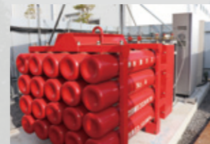
水素発電設備
