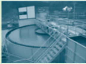
濁水処理設備
