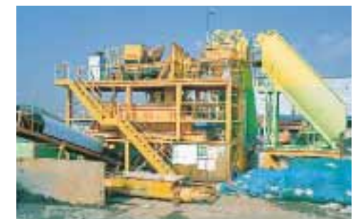
コンピュータ制御による不溶化処理プラント
