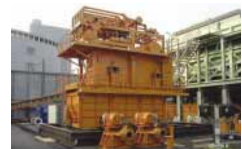
大林式分級洗浄処理プラント
