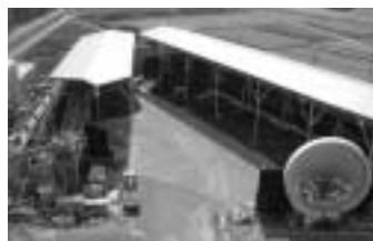
汚水処理設備全景
