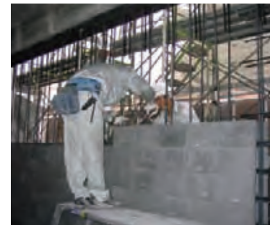
鉄筋を配置しながらブロックを積み上げ、ブロックの内部に特殊な接着材を入れて構築
