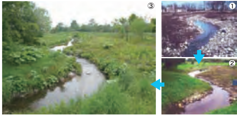
① 堆積した礫を少し掘ると水が浸み出してきた ② 緩い傾斜をつけて水が流れるようにした ③ 現在の様子。緑豊かな植物が群生している
