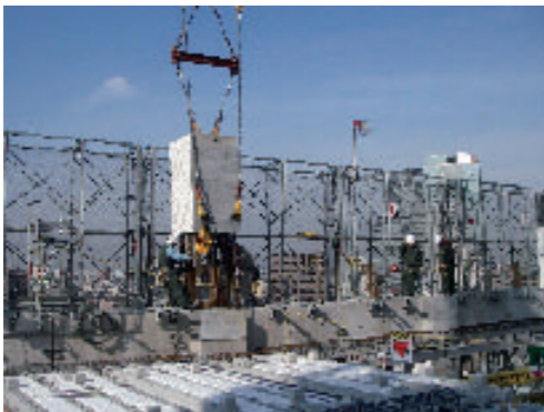
コンクリート部材から伸びる柱主筋をスリーブ継手 *2 に差し込んでジョイント
