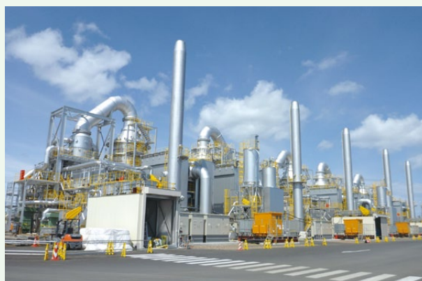
完成した焼却炉。処理完了までに可燃ごみ約22万tを焼却予定
