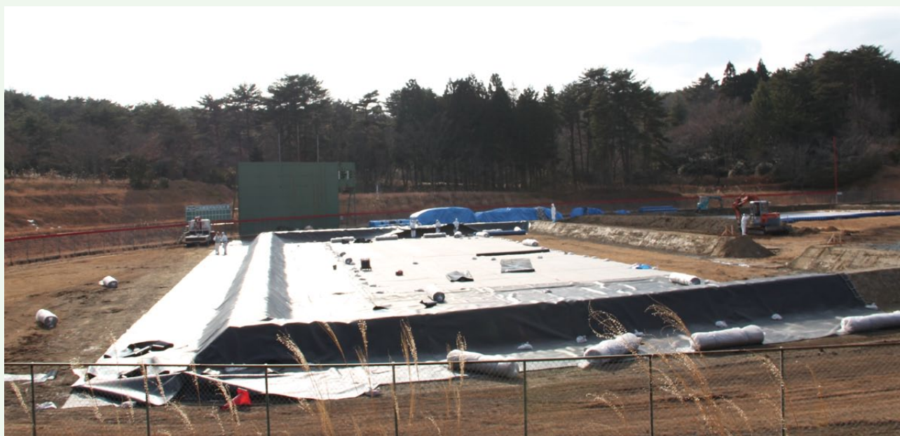
大熊町宮野球場に建設した仮置場。除染作業によって生じる廃棄物や除去物を収納する重要な施設
