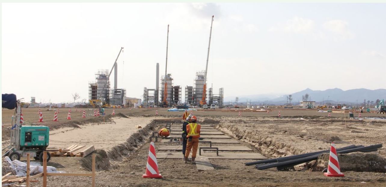
大量に運搬された災害廃棄物を処理するため、5基の焼却炉を建設
