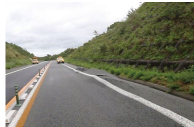
鳴門IC西側の被害状況
