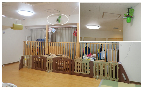
【マルチミスト・配管型導入状況】
