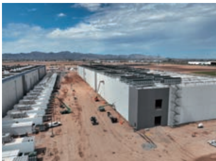
GCON社がアリゾナ州で施工するデータセンター
