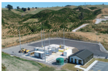
Tuaropaki Trust社と共同で整備した グリーン水素製造・供給施設
