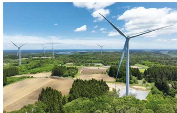
上北小川原風力発電所
