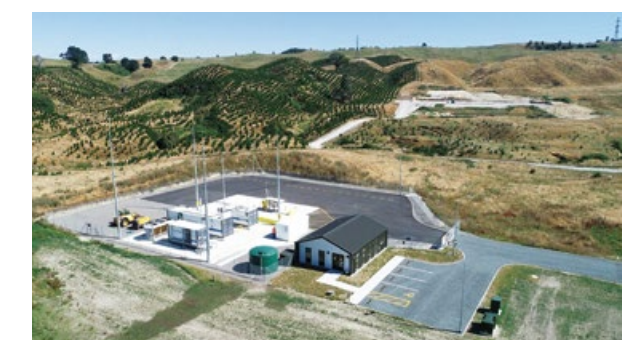
地熱発電所が集中するタウポ湖北側に位置する水素製造プラント
