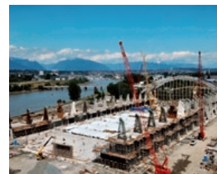
2010年バンクーバー冬季オリンピックの会場となったリッチモンド・スピードスケート競技場の建設風景。ケナイダン社は基礎工事とコンクリート工事を担当
